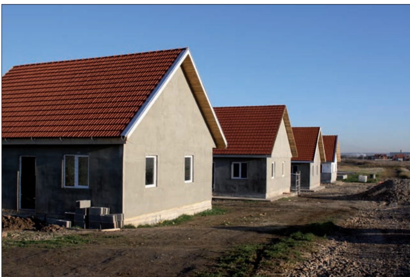
De första av många hus växer nu fram i vad som med tiden kommer bli en hel liten by av hus. Ett på många sätt viktigt steg tas nu som kommer ge många familjer och unga en ljusare framtid.
